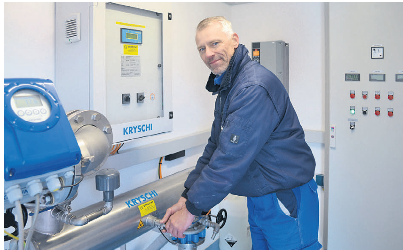
Teamleiter Anlagen, Marko Lorenz, bei der Wartung der UV-Anlage im Tiefbrunnen Großpürschütz.
