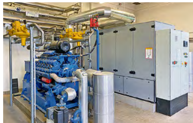
Ein Blockheizkraftwerk erzeugt Strom und Wärme durch das Verfeuern von Brennstoffen.
