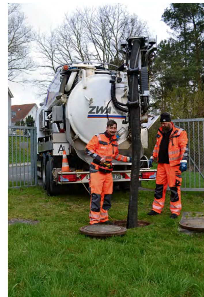
Christoph Opitz und Nico Jäger (v.l.), Mitarbeiter im Bereich Abwasser, beim Spülen des Kanals in Weißenborn, Compaßberg. Foto: (2) ZWA
