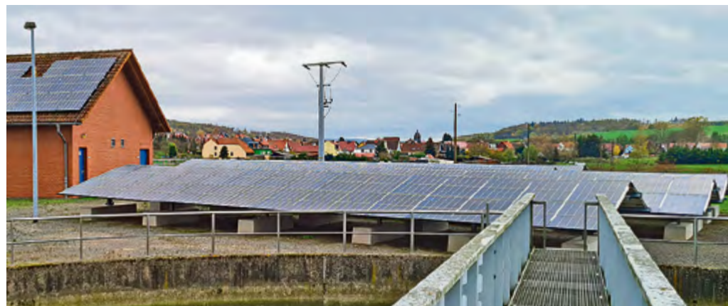
Die Wasser- und Abwasserzweckverbände setzen auch auf Photovoltaik, um Strom für den Betrieb ihrer Anlagen selbst zu erzeugen.
